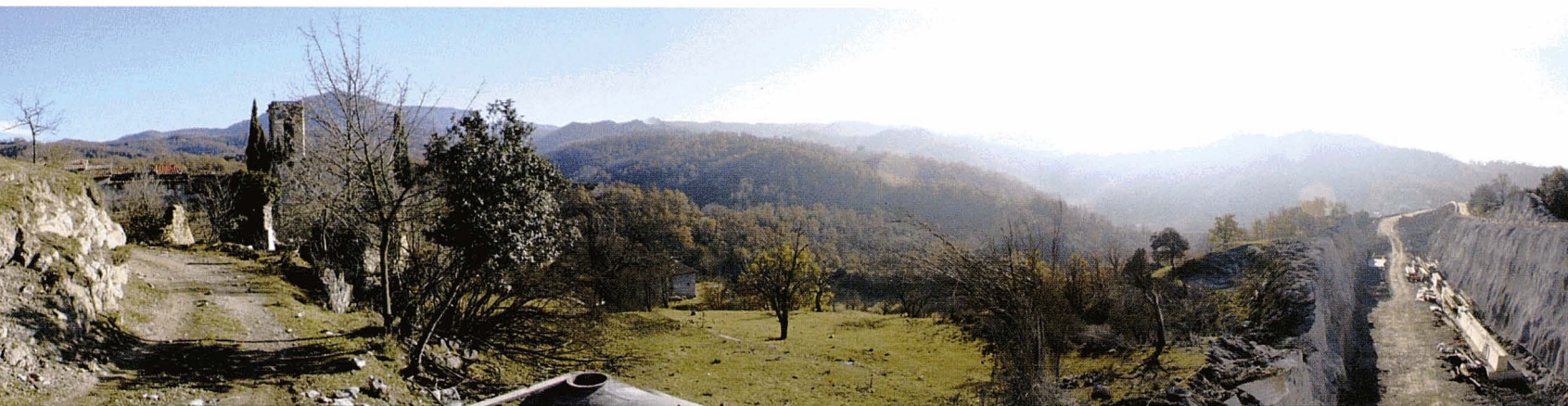
Panoràmica de Sant Andreu de la Vola, on s'estan realitzant les obres del túnel de Bracons
