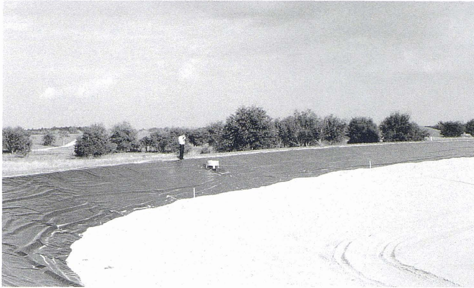
Llacuna d'infiltració ràpida per a la recàrrega d'aqüífers. Projecte Apricot, desenvolupat per la ciutat d'Orlando i el comtat d'Orange, a Florida, per a la recàrrega d'aqüífers i el reg de cítrics. La capacitat inicial del projecte va ser de 100.000 m 3 /dia, per a regar 3.200 ha de cítrics i recarregar l'aqüífer mitjançant seixanta llacunes de 100 m per 50 m cadascuna
