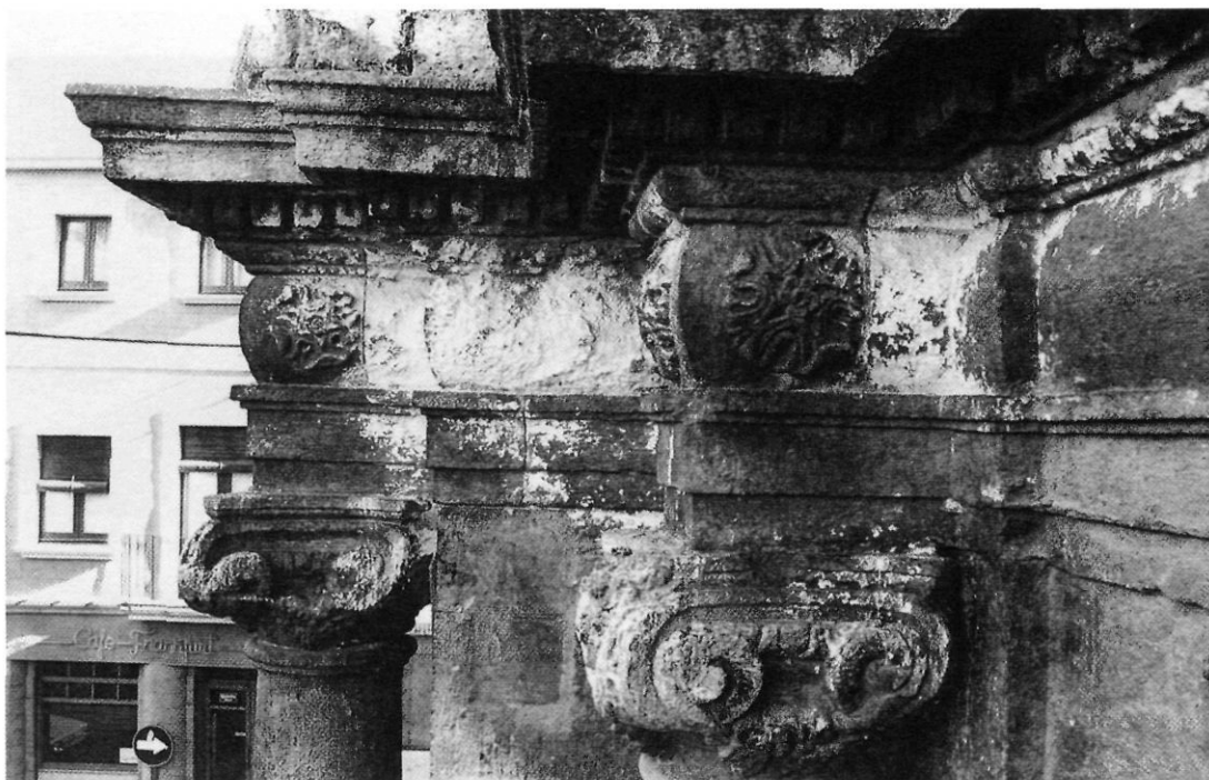
Detall de l'entaulament. S'observa l'arenització de la pedra a causa de la presència de sals solubles o d'una disgregació dels seus elements detrítics o biogènics per la pèrdua del ciment carbonatat. L'arenització causa la pèrdua de volum dels elements constructius provocant, indirectament, la destrucció dels elements decoratius (Pau Arroyo, 26/2/98).
