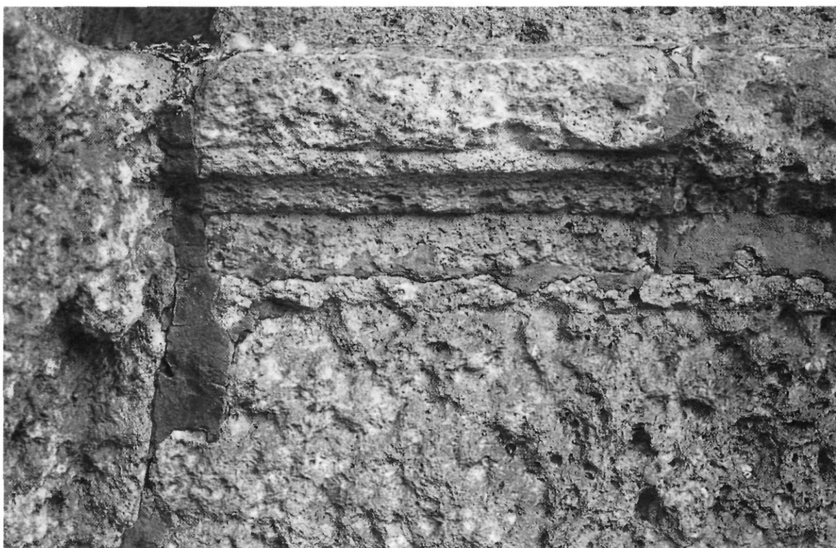
Macrofotografia del basament de la portalada. És evident l'alteració dels materials lítics que formen el monument. Es poden apreciar les formes d'alteració conegudes amb el nom de piting i alveolització. Igualment, la imatge mostra un rejuntament de morter de ciment, el qual no és adequat per tractar els materials històrics (Pau Arroyo, 26/2/98).
