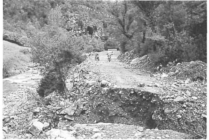
Esbotzament de la pista forestal a l'alçada del torrent de Bolacell, fruit d'haver mesurat incorrectament el cabal potencial d'aigua que podia transportar el torrent. Subtram 2.1: Pont de Bolacell-Cordonet (Juny de 1992).
