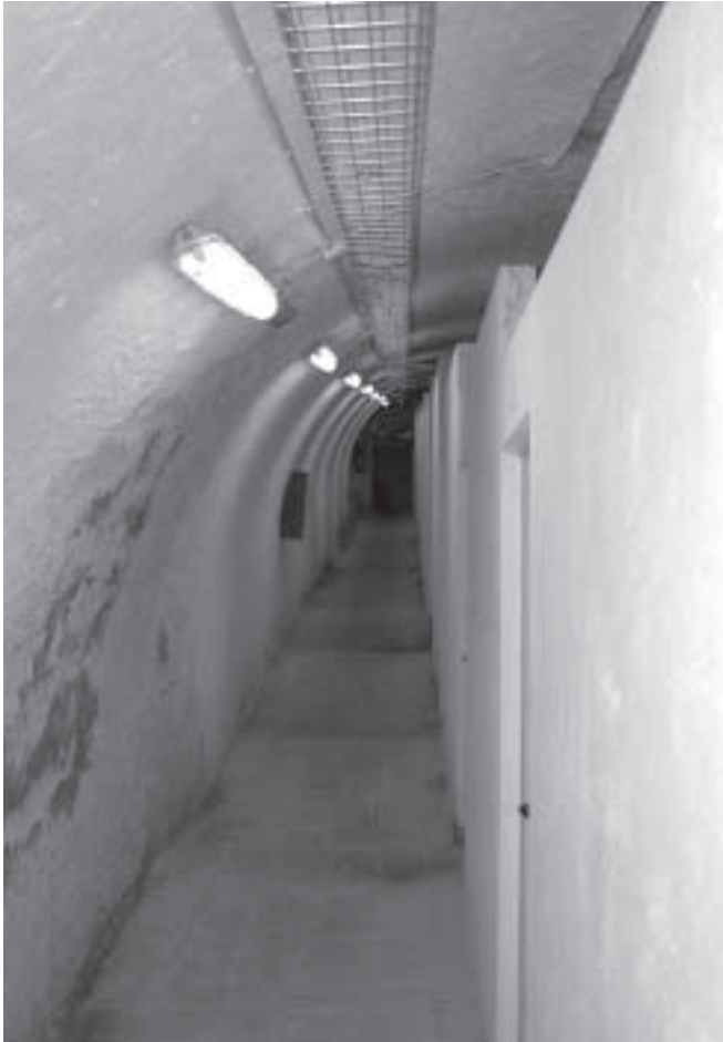
Estat actual de la rampa d'accés al refugi número 1.
