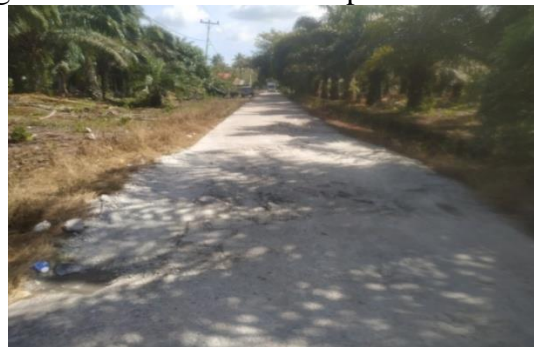
Gambar 7 Kondisi jalan existing pada STA 01+250
