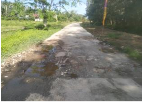
Gambar 1 Kondisi Jalan Saat Ini
