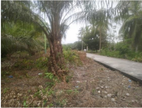
Gambar 7 Kondisi jalan existing pada STA 02+050
