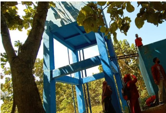
Gambar 2. Kondisi bagian bawah penampung air sebelum terpasangnya rangkaian alat filtrasi dan uv.
