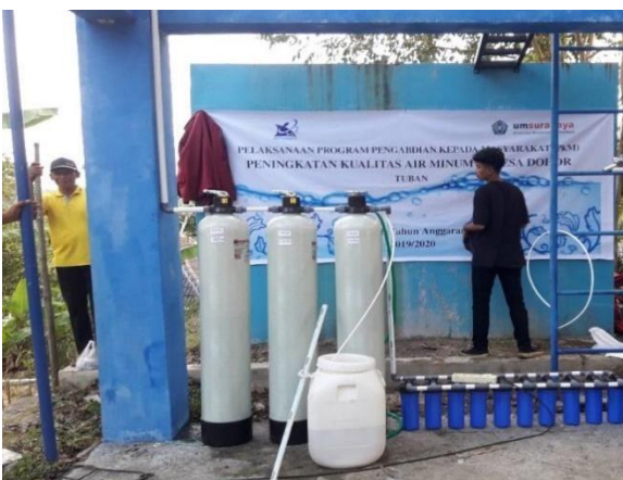
Gambar 3. Kondisi bagian bawah penampung air setelah terpasangnya rangkaian alat filtrasi dan Sinar UV Dari gambar tersebut menunjukkan bahwa alat filtrasi air yang berlokasi di
