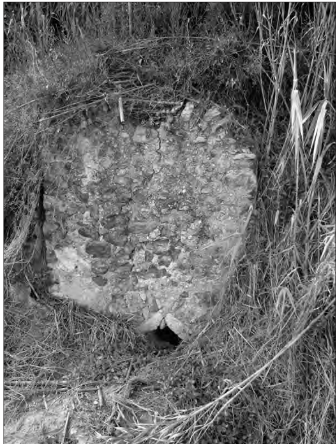
□ Figura 1: Captació de l'aigua de la mineta dins de la sèquia del molí.
