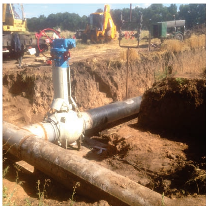
Рис. 4. Вузол приєднання відгалуження DN 700 приварений до лупінгу DN 1000 в районі крану № 8
