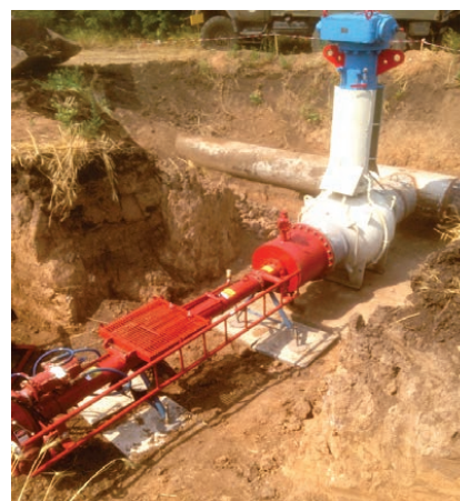
Рис. 3. Машина для врізок з гідравлічним приводом моделі фірми TD Williamson з корпусним адаптером змонтована до вузла приєднання відгалуження
