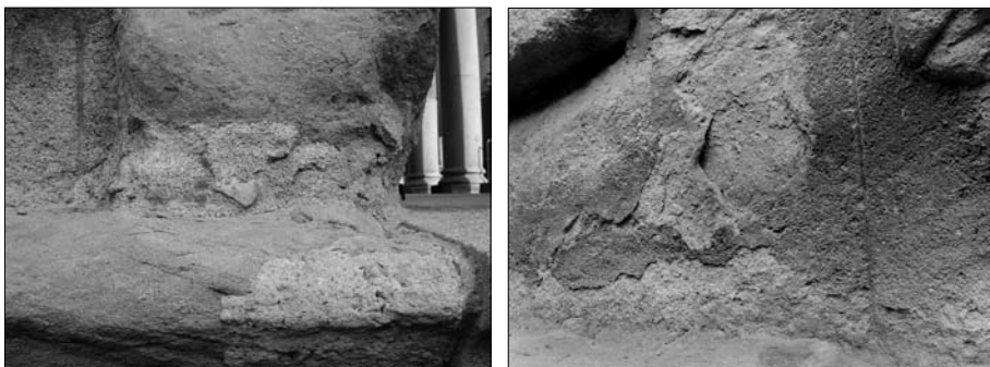
Detalls dels morters de reposició. S'observen les degradacions produïdes al suport de pedra per l'aplicació d'aquests morters.
