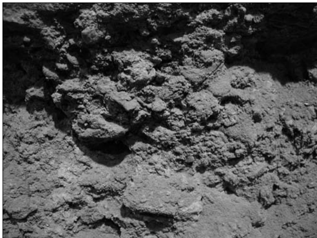
Detall de la maçoneria dels fonaments del temple. S'aprecia la disgregació dels materials constituents.
