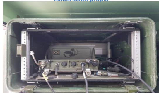
Imagen 28. Cofre enrackable, estación COLMENAR.
