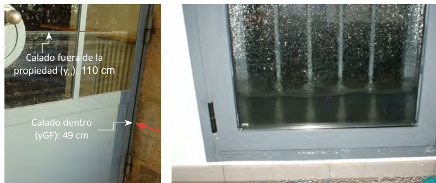
Figura 5 | Marcas de los calados alcanzados por el agua tras un evento de inundación, en el interior y exterior de la propiedad
