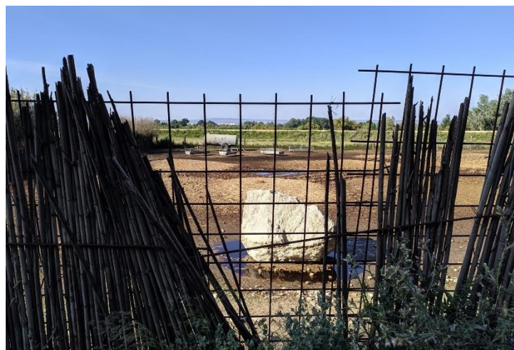
Figura 11.- Bloque desprendido llegando a afectar la granja al otro lado de la pista. La valla en este tramo se observa que ha sido reparada en diversas ocasiones. Coordenadas sexagesimales: 41°43'35"N 0°57'35"W. Fotografía tomada en campo.
