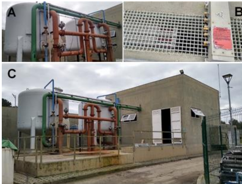
Figura 2 - Tratamento terciário da ETAR Gaia Litoral. A) Filtros de areia; B) Canal de radiação ultravioleta; C) Vista geral do edifício de tratamento terciário.
