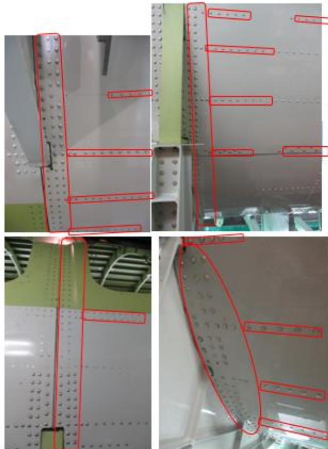
Figura 34 - Alguns rebites da zona exterior do frame 24 antes de serem inspecionados
