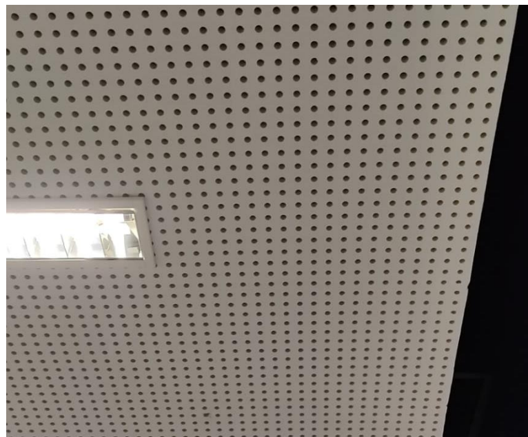
Figura 4.9 – Pormenor do teto em gesso cartonado perfurado com lã de rocha na zona posterior [Foto do autor].
