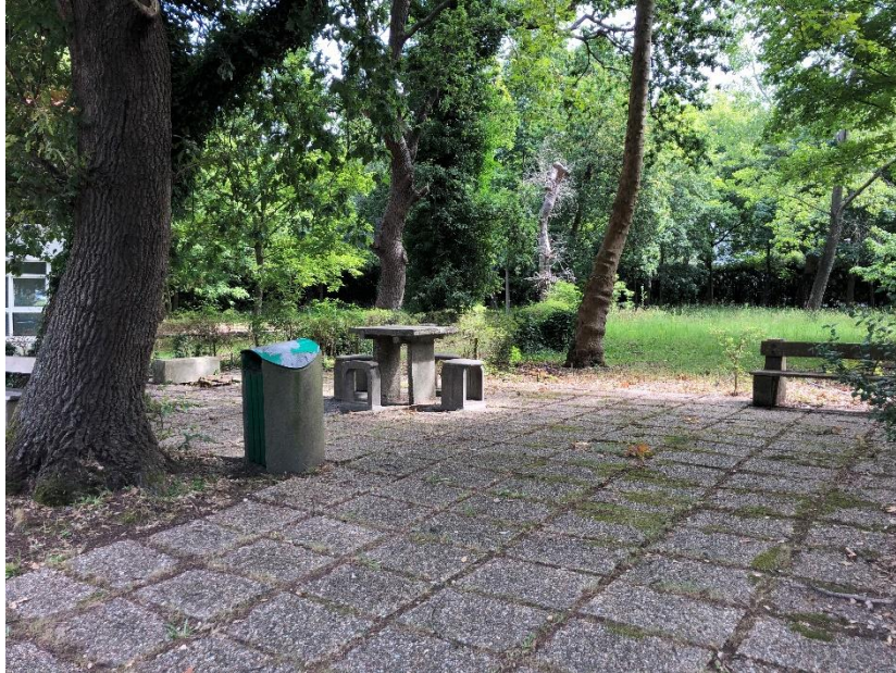
Fig. 9 - Pavimento de lajetas de betão pré-fabricadas desnivelado e em mau estado de conservação (fonte: Acervo pessoal, 2020)
