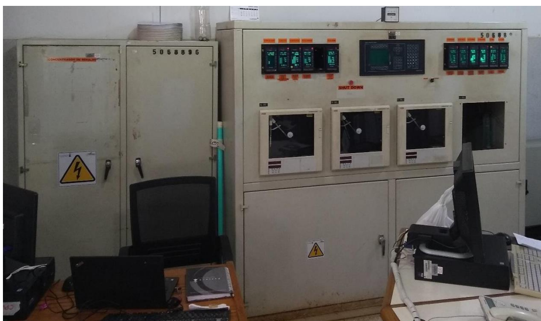
Figura 14. Montaje real de controladores MOD30ML en sala de control.
