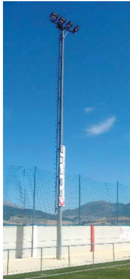
Figura 2.21. Torre de proyectores LED en el Campo de Fútbol de Casabermeja. Fuente: Elaboración propia.
