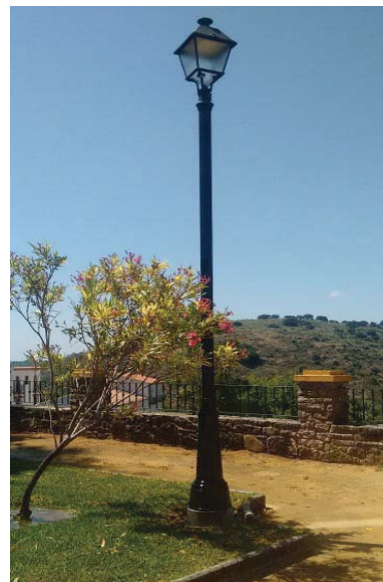
Figura 2.19. Luminaria clásica tipo Villa sobre columna de polímero poliéster y vidrio en Cortes de la Frontera. Fuente: Elaboración propia.
