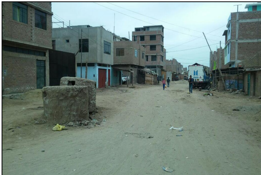
Imagen 6: Buzones en mal estado expuestos en medio de la vía
