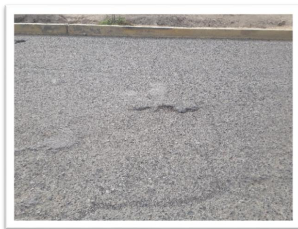
Figura 50. Agrietamiento en bloque
