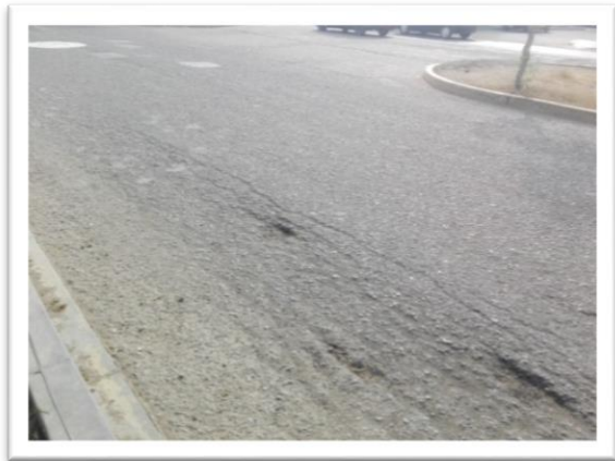
Figura 32. Desprendimiento de agregados
