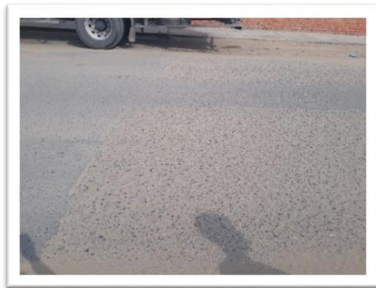
Figura 73. Desprendimiento de agregados
