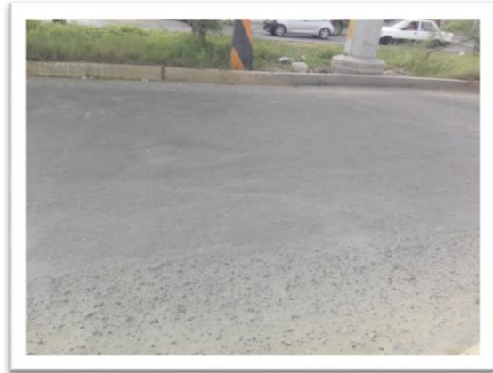
Figura 40. Desprendimiento de agregados
