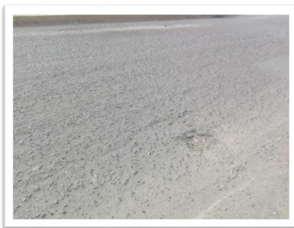
Figura 34. Desprendimiento de agregados
