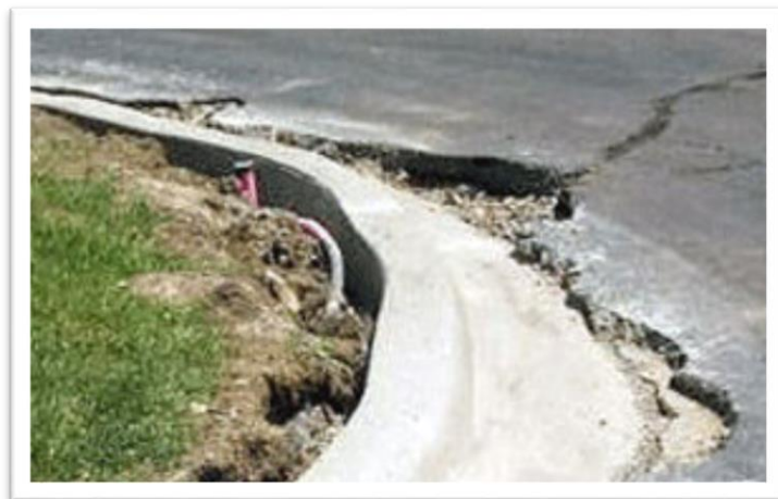
Figura 9. Grieta de borde
