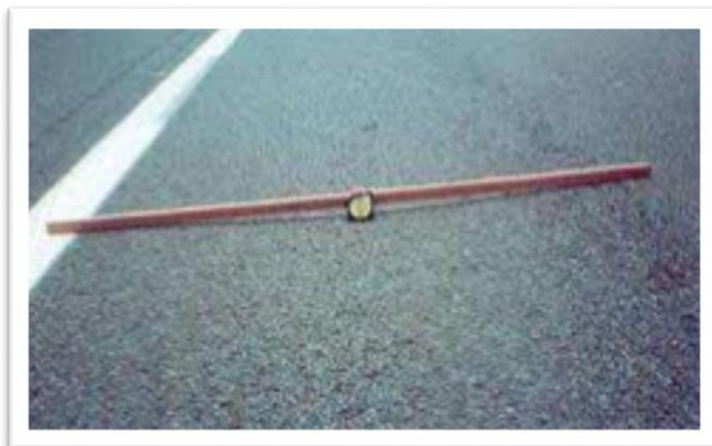
Figura 6. Hundimientos en pavimentos flexibles
