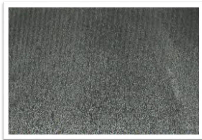
Figura 21. Meteorización y desprendimiento de agregados
