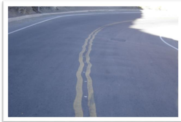
Figura 7. Corrugaciones en pavimentos flexibles
