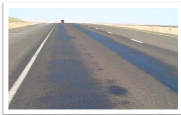
Figura 4. Exudación en pavimentos
