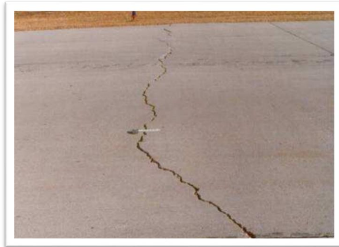
Figura 12. Grietas longitudinales y transversales
