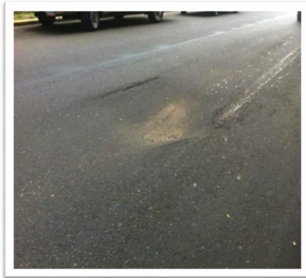
Figura 8. Depresión en pavimentos
