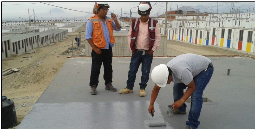
Figura 1.2 Aplicación de solución para corregir la fisuración de pisos residencial “Villa Marina”
