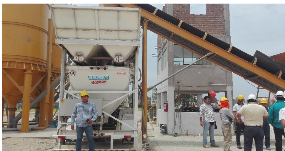
Figura A.2 Caseta de control y dosificación de mezclas de la empresa premezclados Ken S.A.C (Fuente: Propia)
