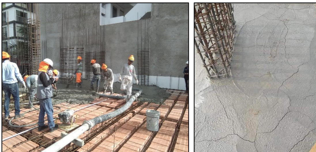
Figura 1.1 Fisuración de losa aligerada que utiliza concreto premezclado, edificio “San Gabriel” - Trujillo (Fuente: Propia)
