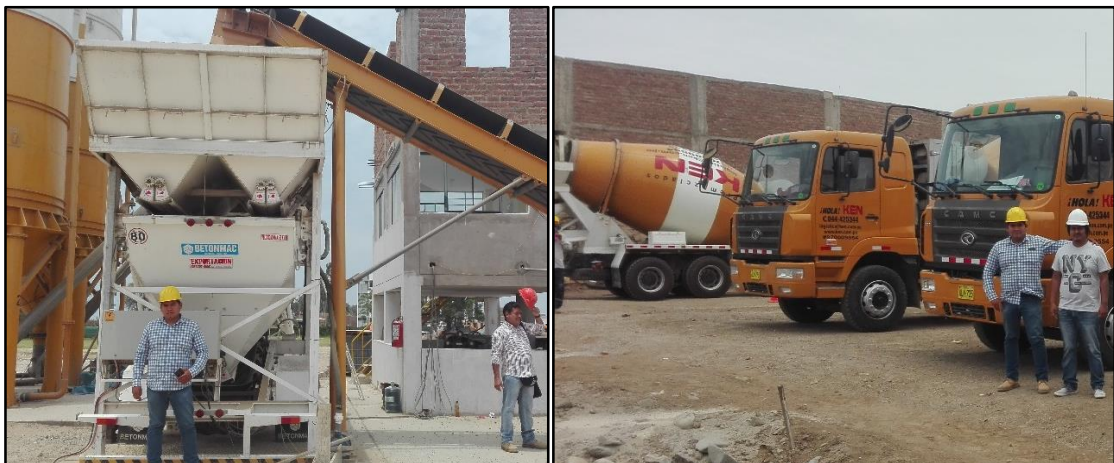
Figura 2.2 Tolva de agregados y Camiones mezcladores, Premezclados Ken SAC. (Fuente: Propia)
