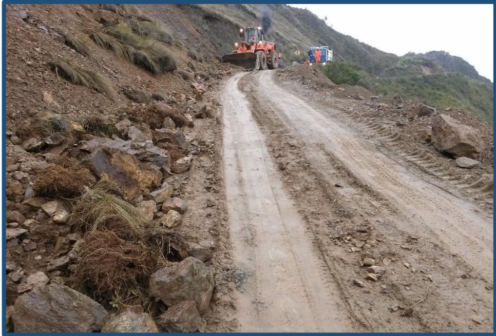
Imagen N°58: Punto Crítico (Km 224+000 al Km 224+200), derrumbe de material suelto entre las progresivas del PGV Km 224+000 al Km 224+200
