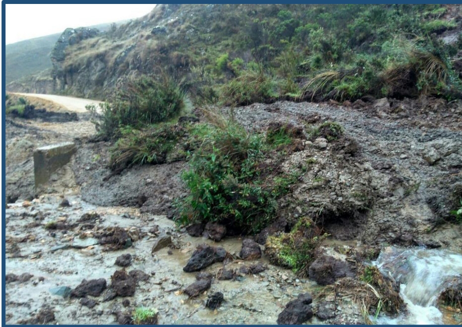
Imagen N°45: Deslizamiento de Huaico en la zona de la quebrada
