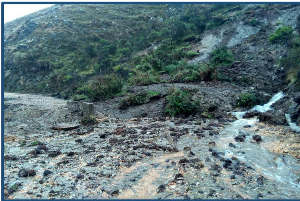
Imagen N°46: Caída del huaico en una quebrada de la Alcantarilla
