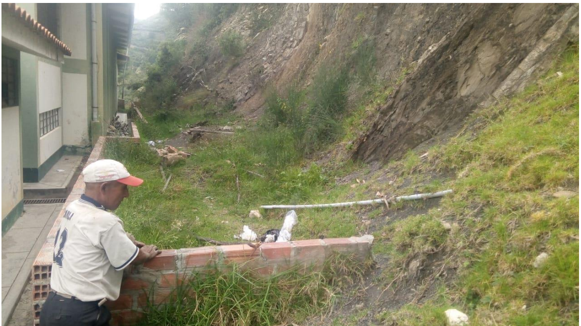
Tuberías expuestas a rotura por habitantes y animales de la zona, esta debería encontrarse enterrada para evitar accidentes o malos inconvenientes.
