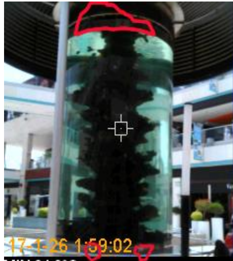
Figura 27: Imagen con zonas de posible generación de corrosión
