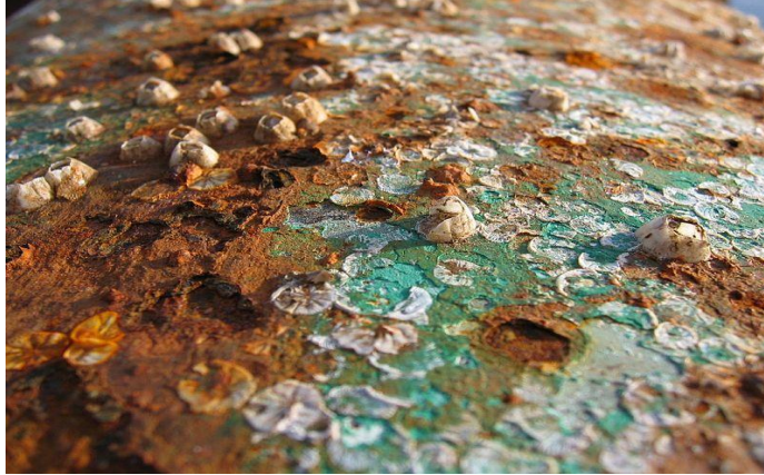
Figura 36: Corrosión del metal en estado terminal
