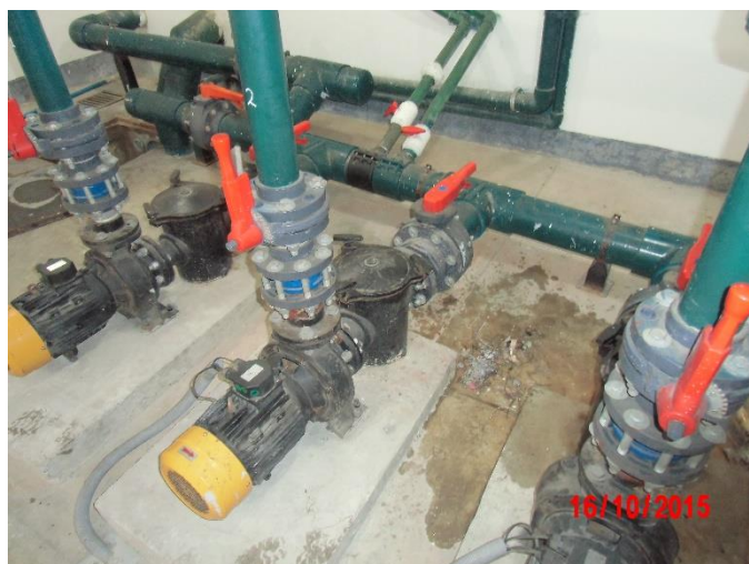
Ilustración 8 Bombas de recirculación de la piscina Gildemeister.
