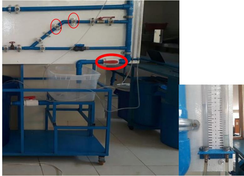
Figura N°38. Válvulas para Purgar el Manómetro columna de Agua. P
