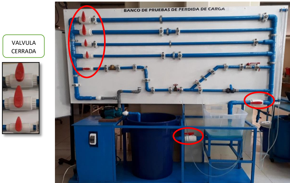
Figura N°37. Válvulas de Control. P Fuente: elaboración propia.
