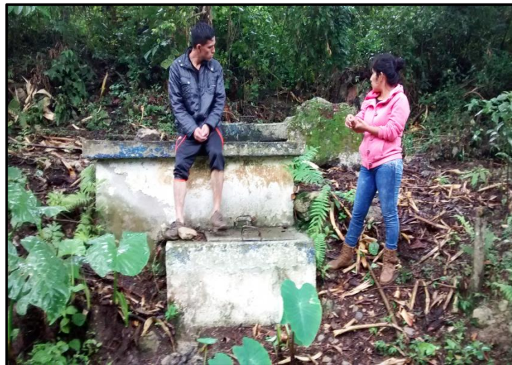
Figura 4. Exterior de Cámara Colectora (Vista de Perfil)
