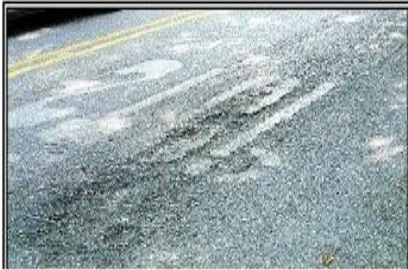
Figura N° 10 Desintegración de la carpeta
