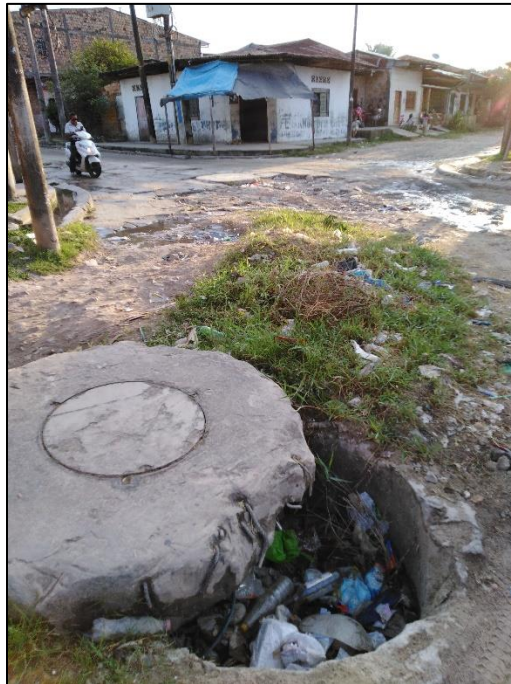
Figura 13: basura acumulada cerca a la cuneta
