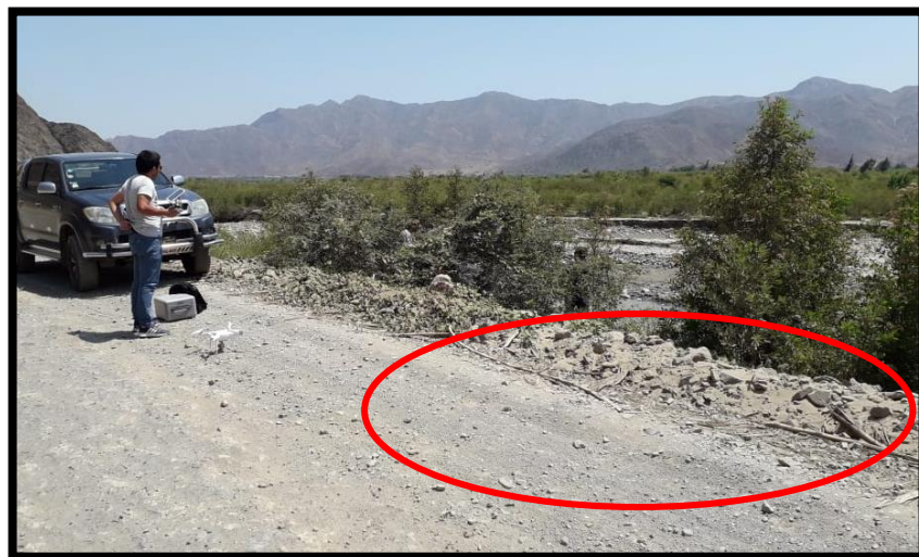
Ilustración 02: Se aprecia la carretera que está dañada por desborde del río del año 2017.
