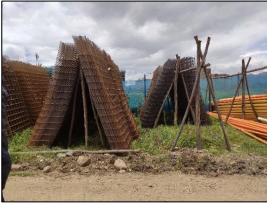
Figura 17 Acero sin protección
