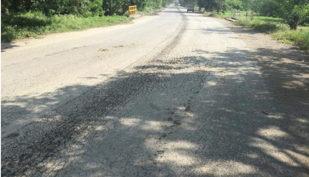
Fotografía 4. PR137+800-PR137+900: Fisuramiento PC y hundimiento
