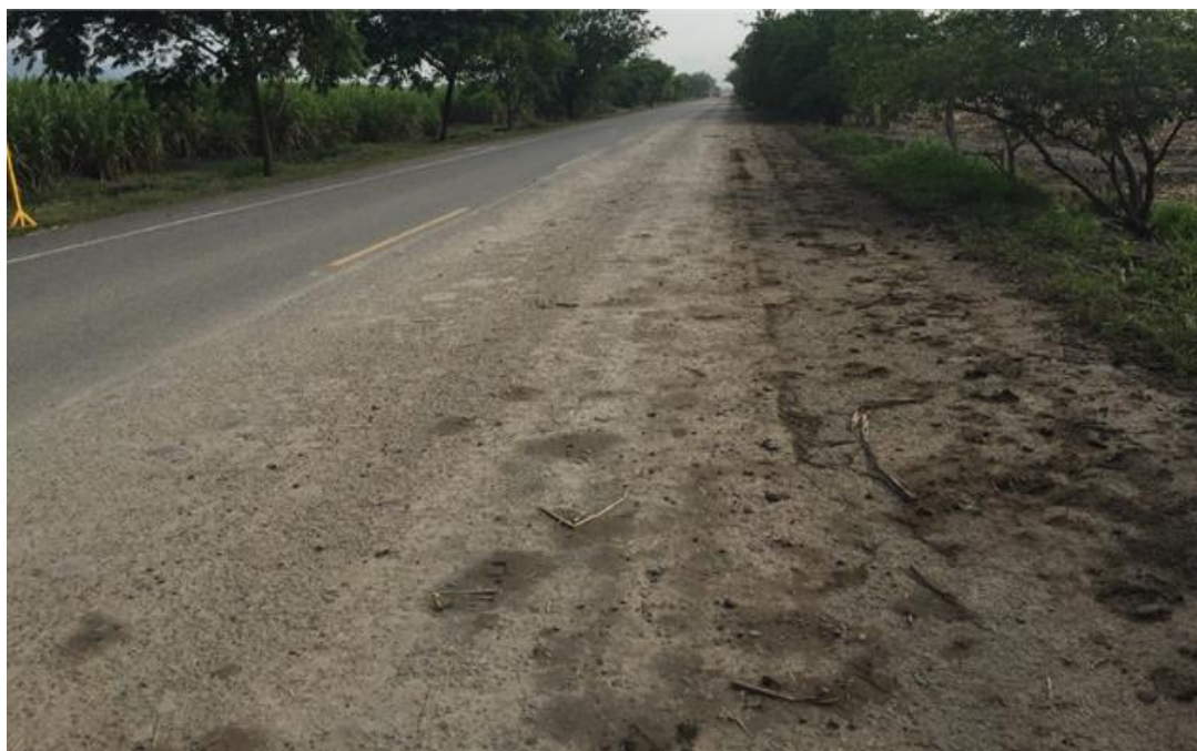
Fotografía 2. PR135+050: Contaminación en la calzada generada por trenes cañeros provenientes de cultivo con acceso en el PR134+700
