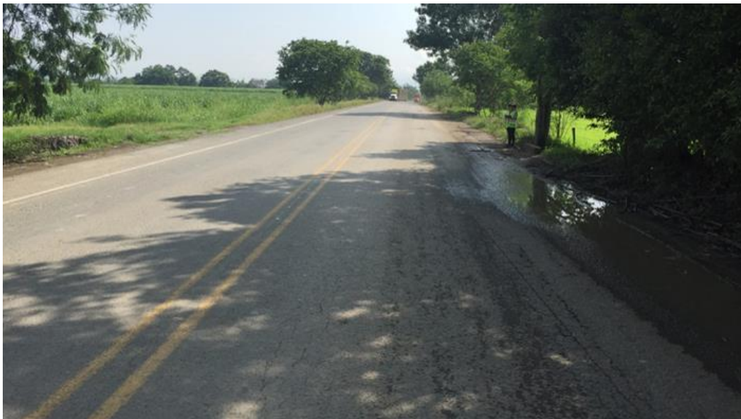
Fotografía 3. PR137+300 - PR137+500. Fallas PC y hundimiento
