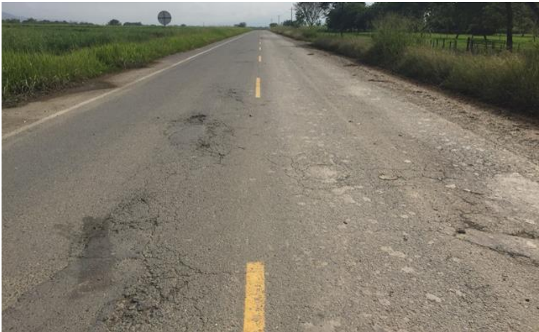
Fotografía 5. PR139+900: Sitio con fisuras en medialuna en la margen derecha
