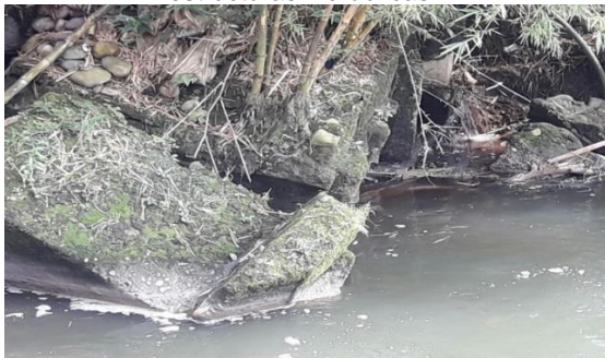
Ilustración 3. Colapso estructural de antiguas estructuras hidráulicas
