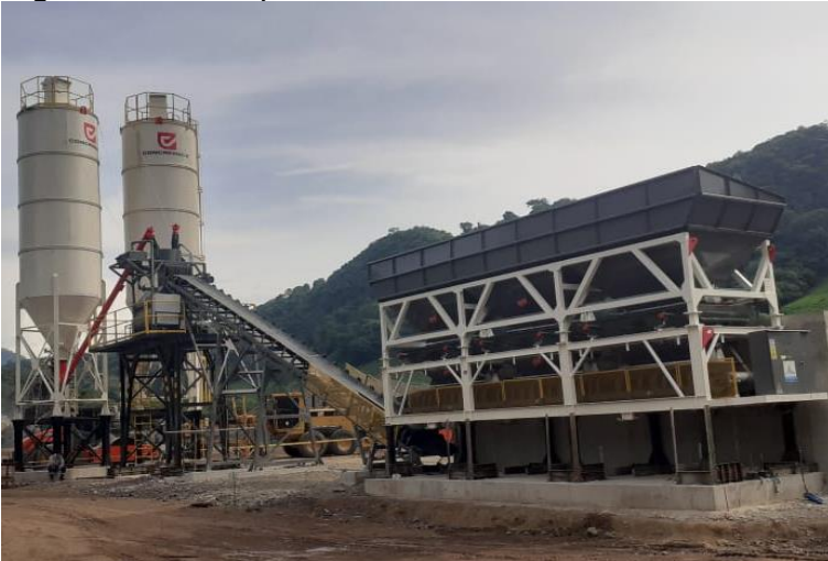
Figura 3. Planta premezcladora de concreto modelo AM-80m 3 /h
