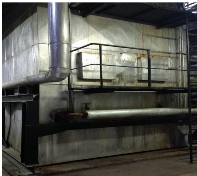
Figura 3.6 - Caldeira de recuperação de calor instalada no sistema de trigeriação da MRI
