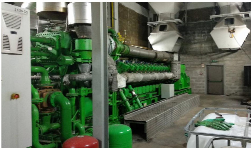
Figura 3.5 - Motor de 4.4 MW da unidade de trigeriação da MRI
