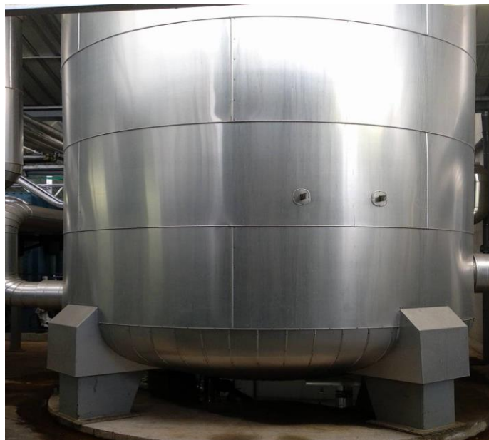
Figura 3.7 - Tanque reservatório de água fria instalado na MRI
