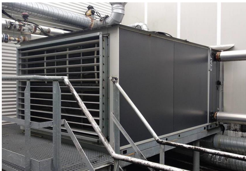
Figura 3.9 - Exemplo de uma unidade exterior de tratamento de ar da MREF
