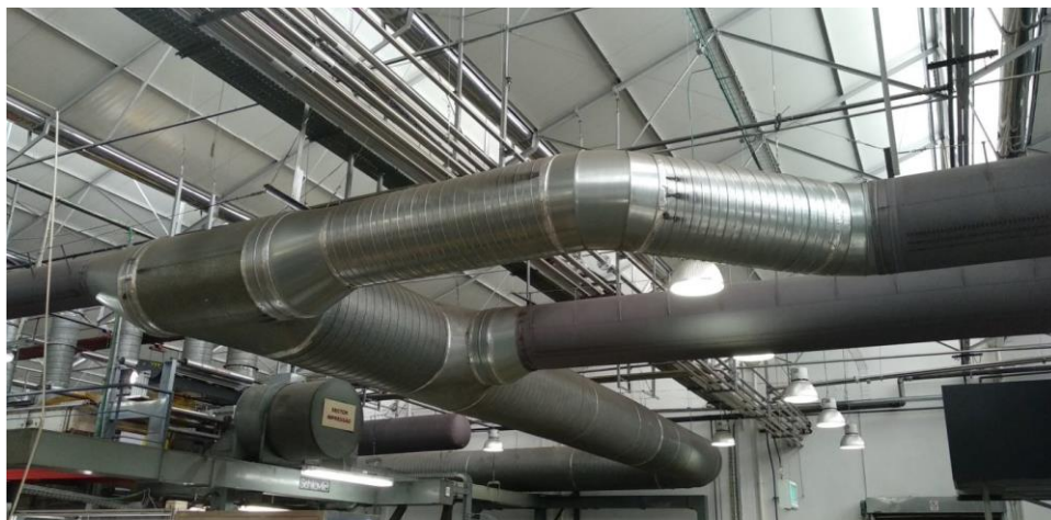
Figura 3.10 - Condutas e mangas têxteis da instalação
