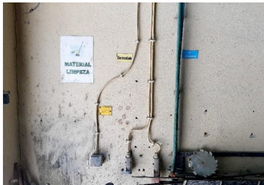
Figura 15 - Identificações de material de limpeza, eletricidade e ar comprimido
