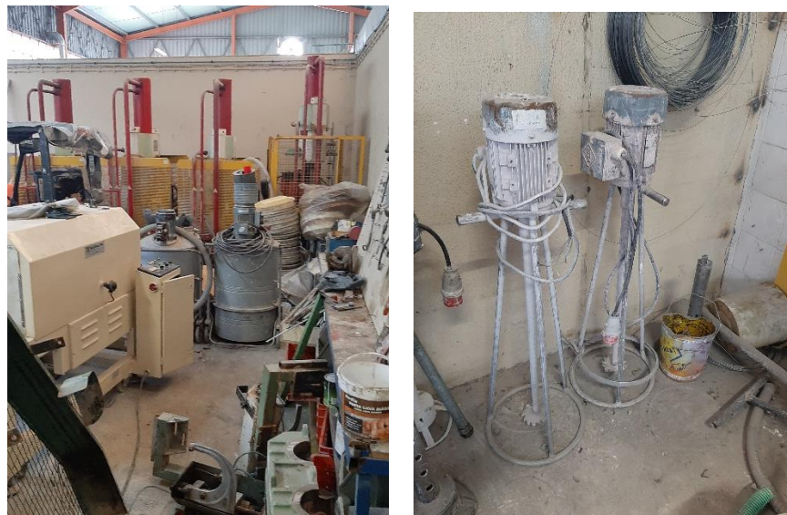
Figura 11 - [A] Prensas (ao fundo); [B] Bombas de vidragem (ambos não utilizados)
