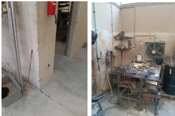
Figura 17 - [A] Pintura danificada; [B] Azulejos “picados”
