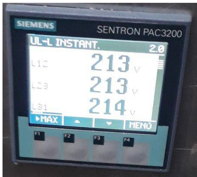
Figura 24. Variables eléctricas mostradas en analizador de red.
