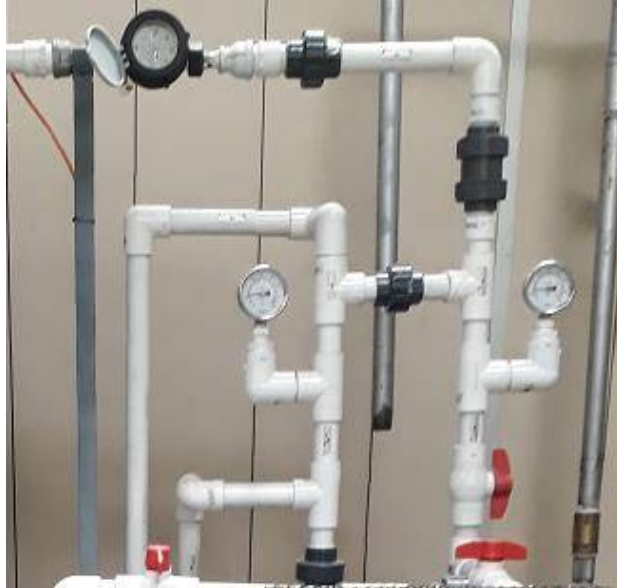
Figura 12. Tuberías del sistema de bombeo
