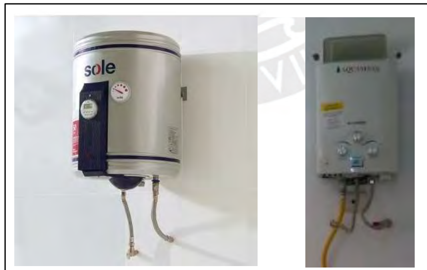
Figura 6. Generación de agua caliente en viviendas
