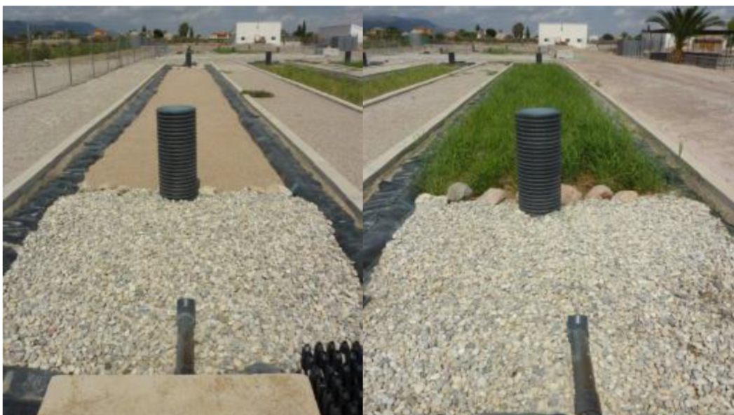
Imagen 4.7. Humedal artificial de flujo subsuperficial. Celda 1 sin plantación (izda.) y Celda 2 plantada (dcha.).
