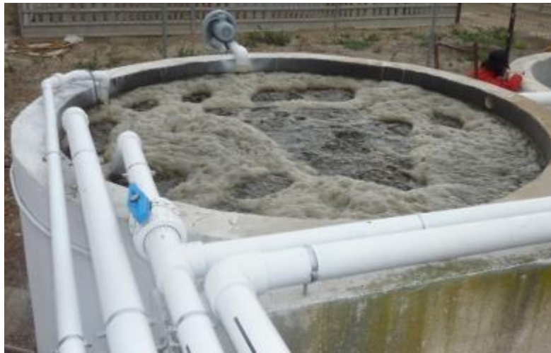
Imagen 4.5. Depósito de aireación en funcionamiento.
