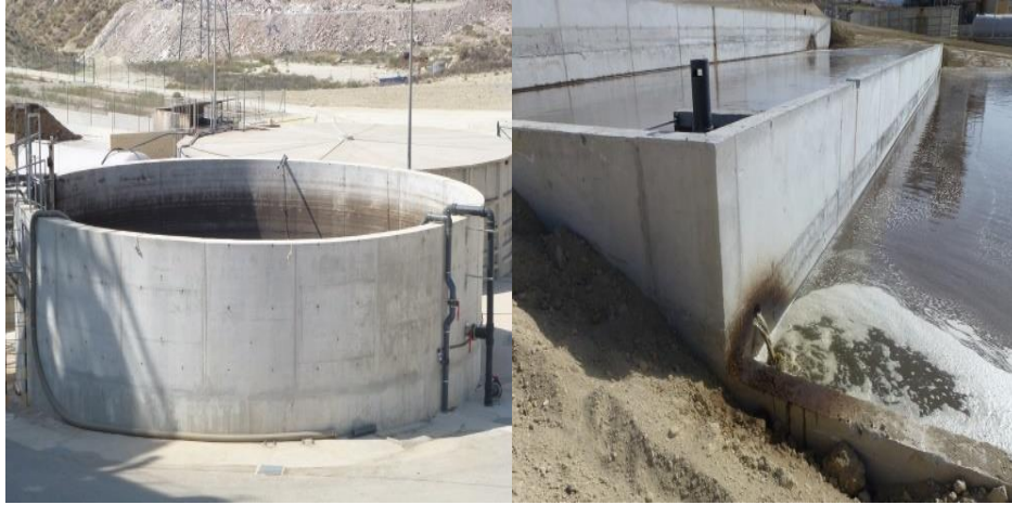
Imagen 5.6. Tanque de decantación cónico (B3) y tanque de regulación (D1)
