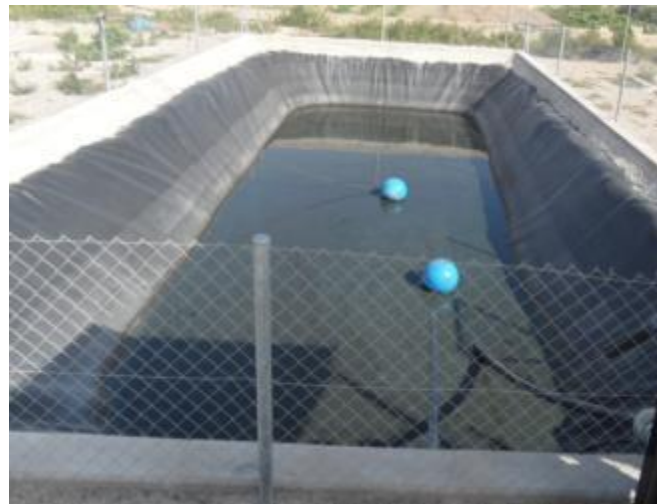
Imagen 4.8. Balsa de almacenamiento (BA) del efluente tratado.
