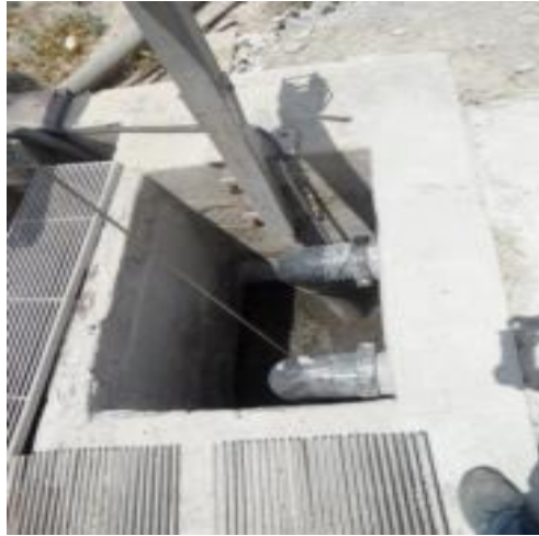
Imagen 4.3. Foso de almacenamiento de purín bruto.
