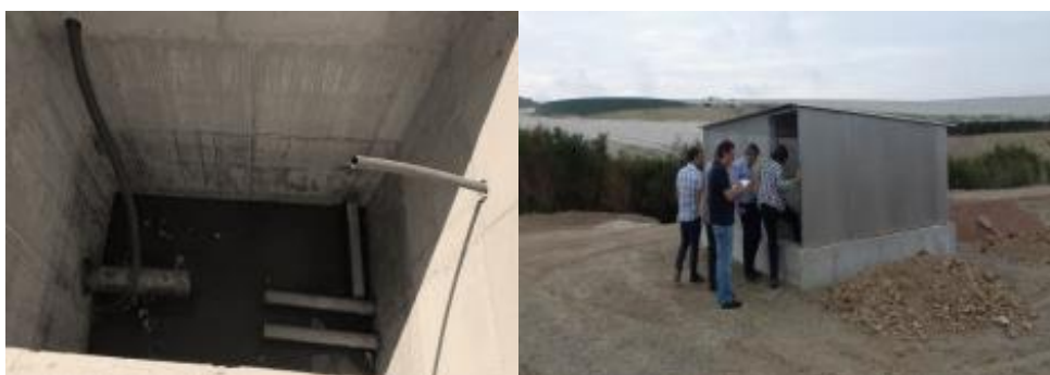
Imagen 5.9. Arqueta general (izda.) y estación bombeo (dcha.).
