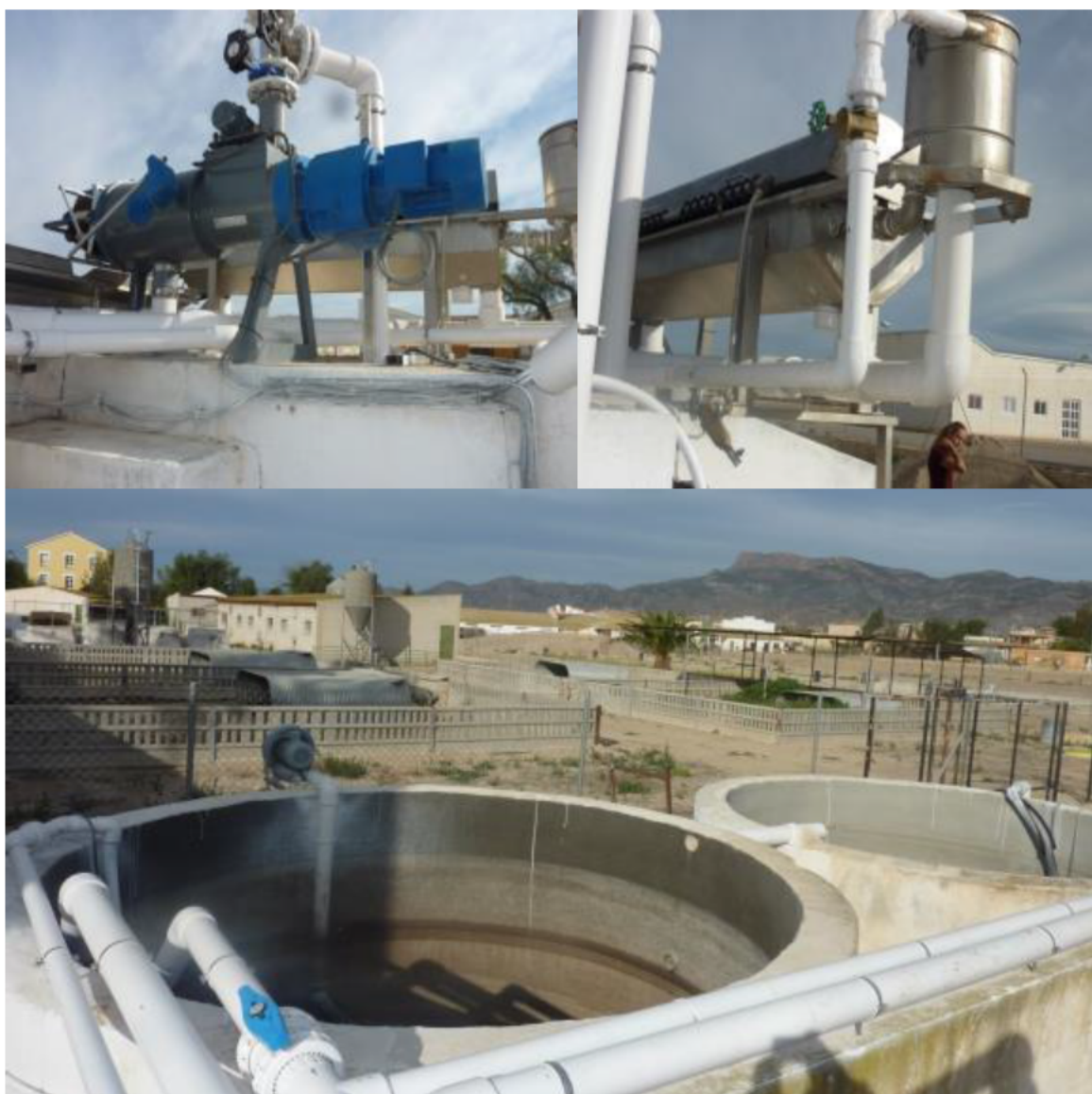
Foto 8.13. Instalaciones sistema de tratamiento ensayo piloto.
