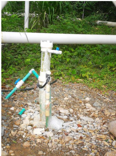
Figura 15. Cloración por Pastilla. Cebadilla de Puntarenas. Fuente: Elaboración propia.
