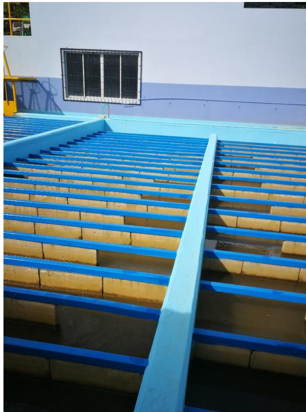
Figura 14. Sedimentador Planta de Potabilización AyA en Barranca. Fuente: Elaboración propia.
