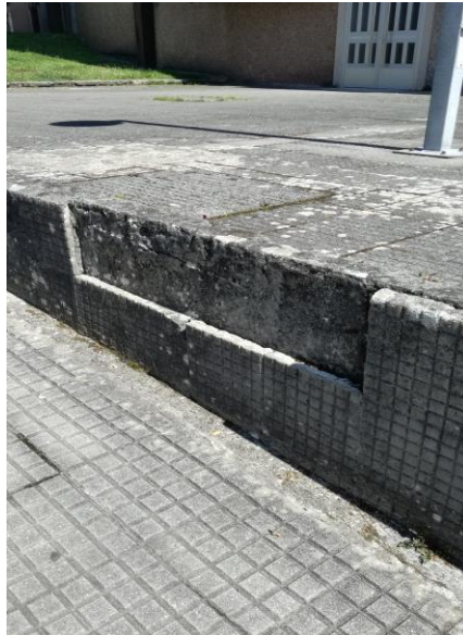
Imaxe 6. Muro con baldosas rotas na rúa de Carlos Maside.
