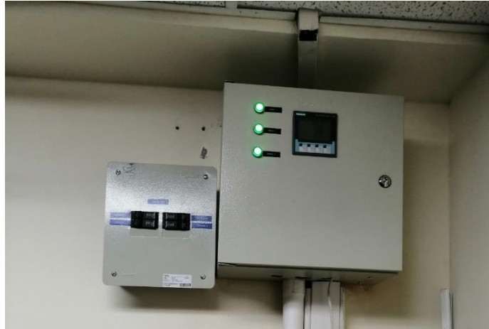
Figura 26. Fotografía del tablero eléctrico
