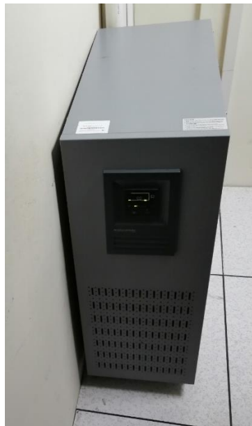
Figura 27. Fotografía del UPS
