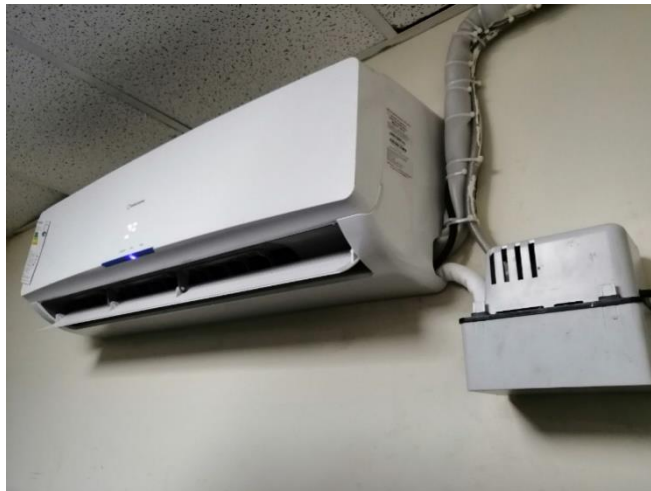
Figura 29. Fotografía del sistema de aire acondicionado
