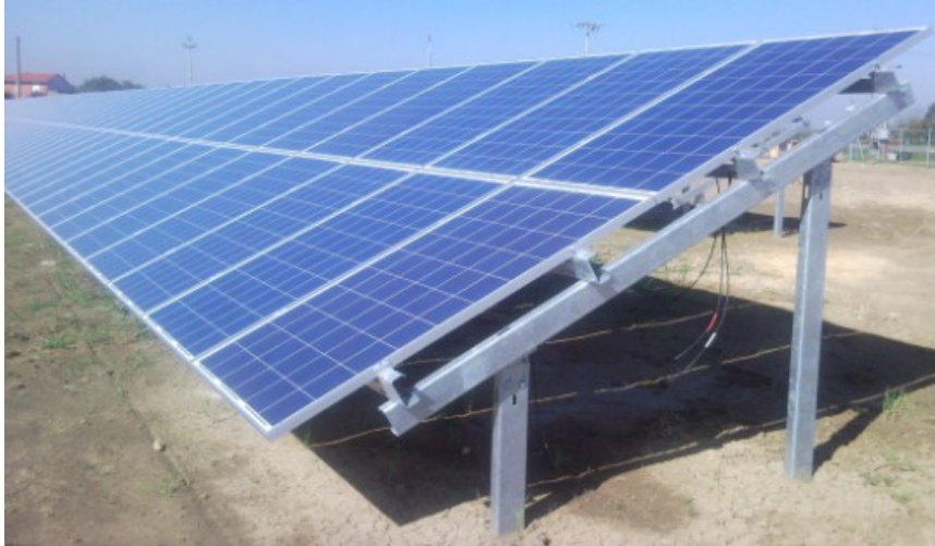
Figura 19. Estructura fija con hincado directo y biposte
