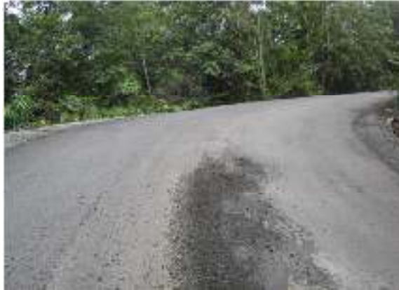
Gambar 2.11. Retak susut ( shrinkage cracks )
