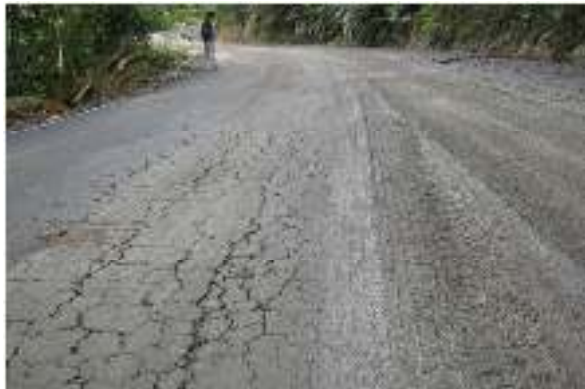
Gambar 2.10. Retak refleksi ( reflection cracks )
