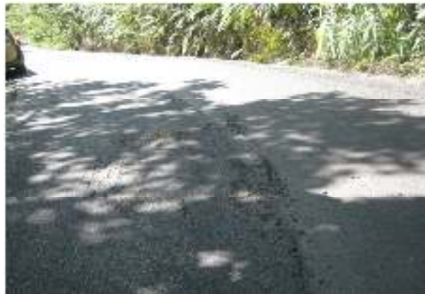
Gambar 2.7. Retak pinggir ( edge crack )
