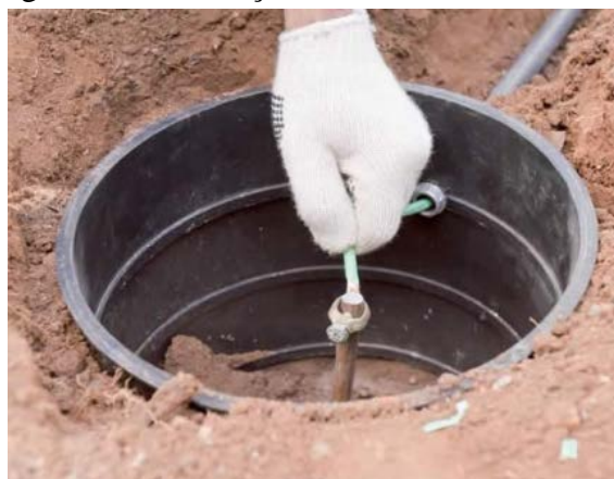
Figura 3 – verificação de haste de aterramento
