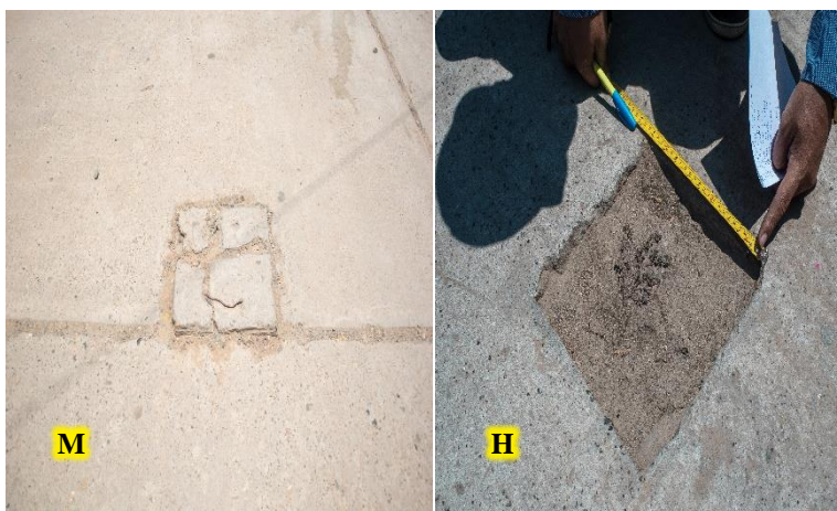
Figura 12. Daños de parche (pequeño) en dos tipos de severidad. (Fuente: Elaboración Propia - 2019).
