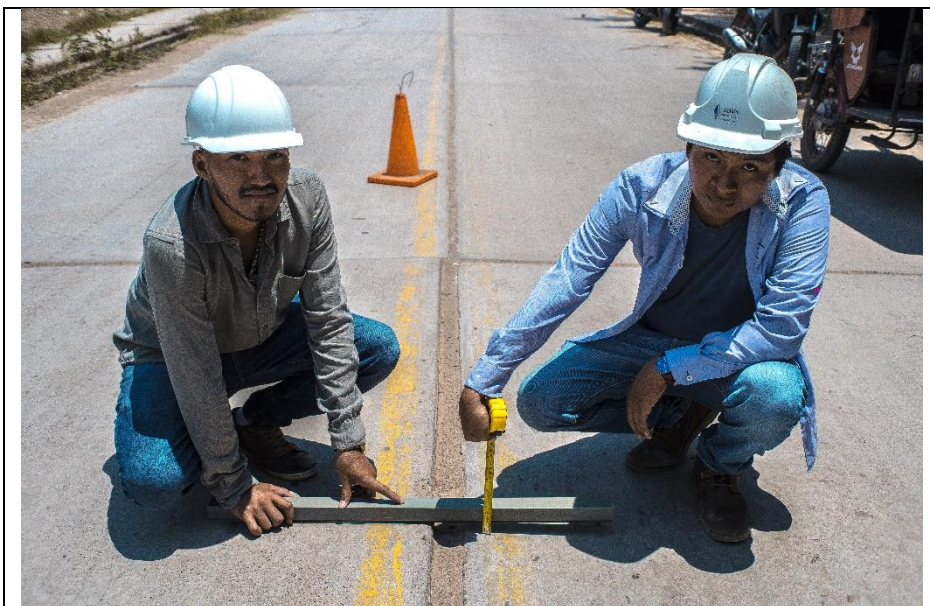
Foto 19: Realizando la medición del daño de escala para evaluar su severidad.
