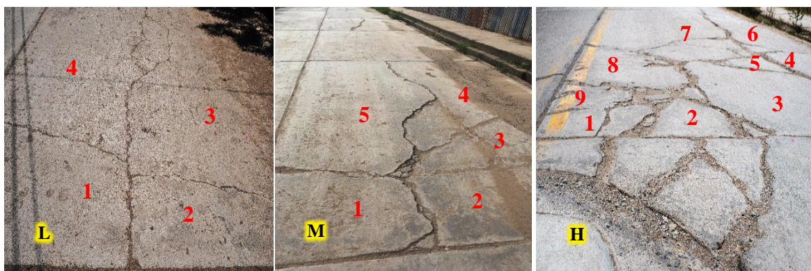
Figura 7. Daños de losa dividida en sus tres tipos de severidad. (Fuente: Elaboración Propia - 2019).
