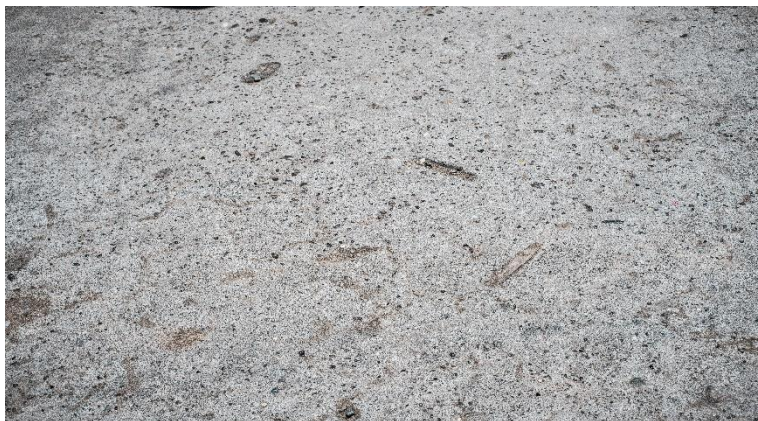
Figura 14. Daño de popouts. (Fuente: Elaboración Propia - 2019).
