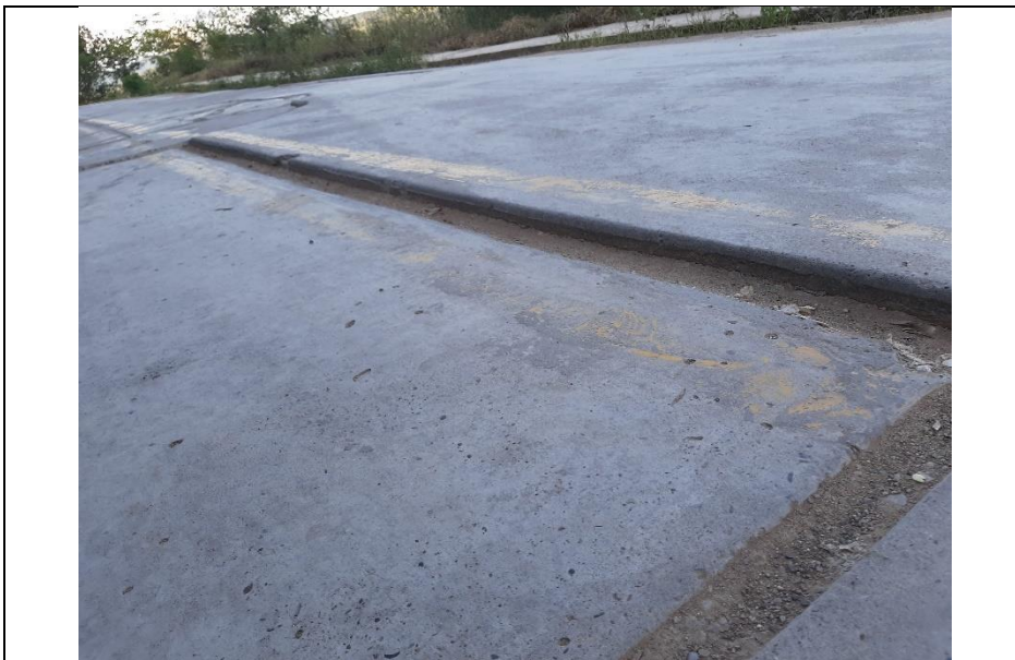
Foto 30: Daño de bombeo muy notable.
