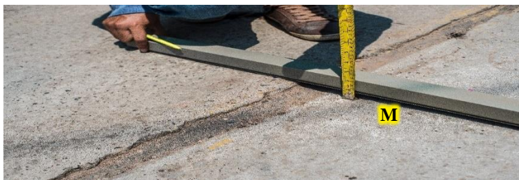
Figura 8. Daño de escala de severidad M. (Fuente: Elaboración Propia - 2019).
