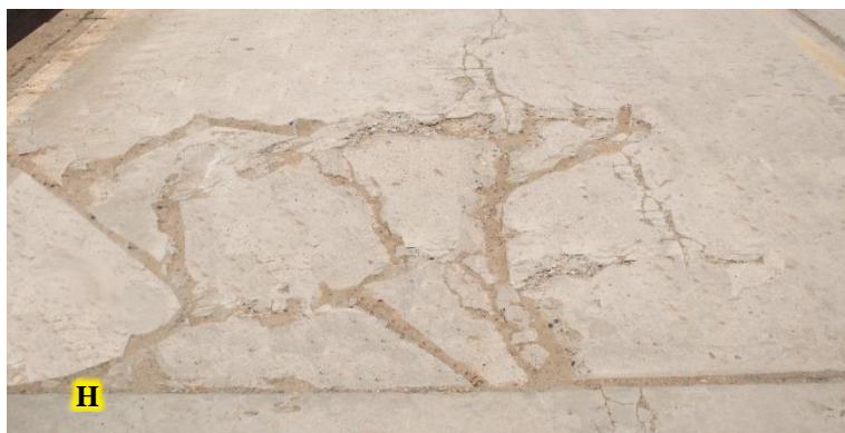
Figura 16. Daño de punzonamiento de severidad H. (Fuente: Elaboración Propia - 2019).
