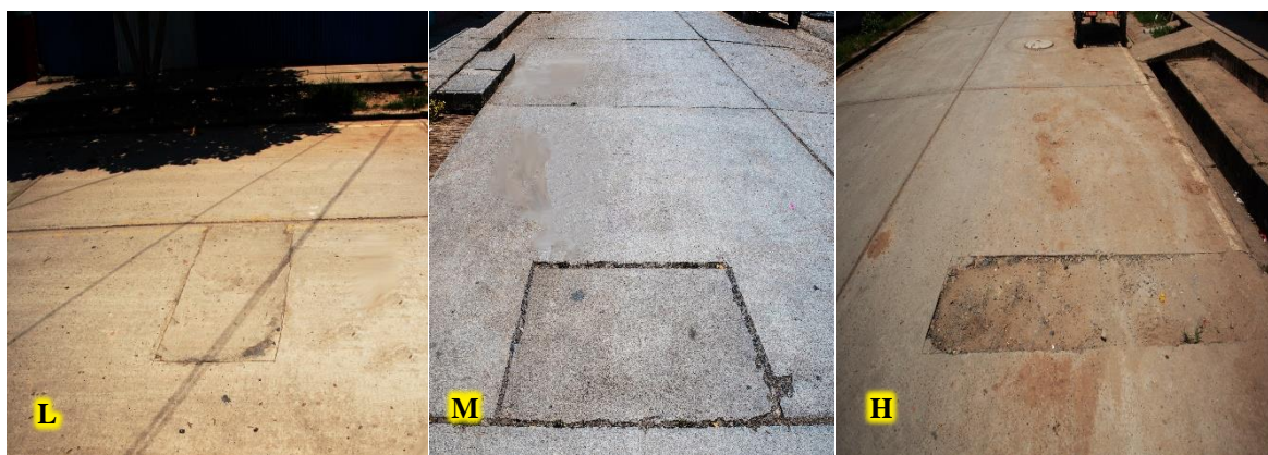
Figura 11. Daños de parche (grande) en sus tres tipos de severidad. (Fuente: Elaboración Propia - 2019).
