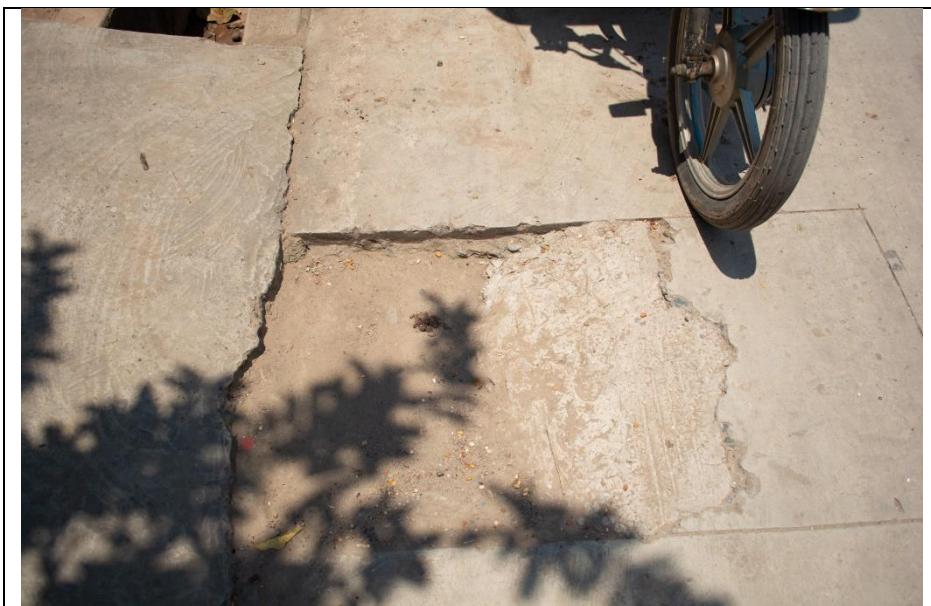
Foto 27: Daño de parcheo pequeño de severidad media.
