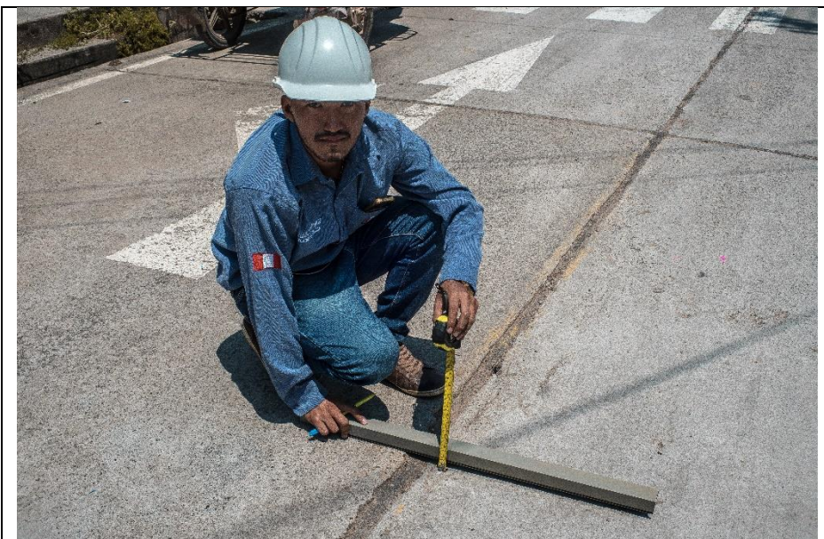
Foto 10: Realizando la medición del daño de escala para evaluar su severidad.
