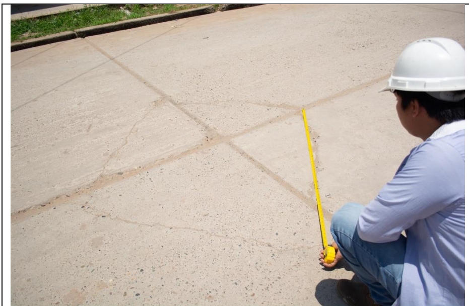
Foto 15: Realizando la medición del daño de grieta de esquina para evaluar su severidad.
