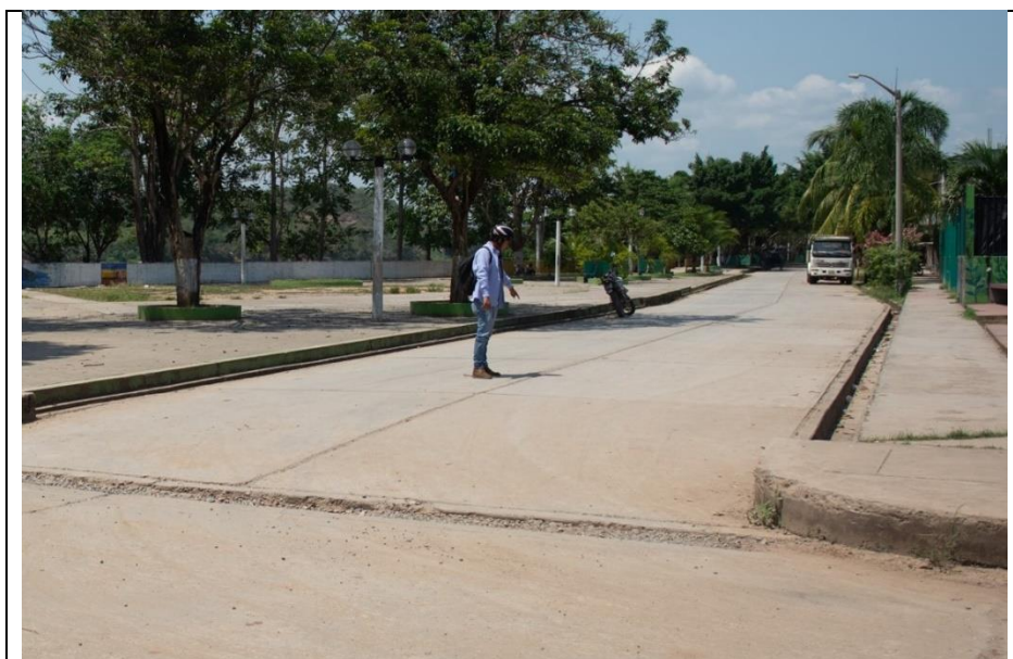
Foto 8: Reconociendo las patologías presentes en el Jr. Malecon C-2.
