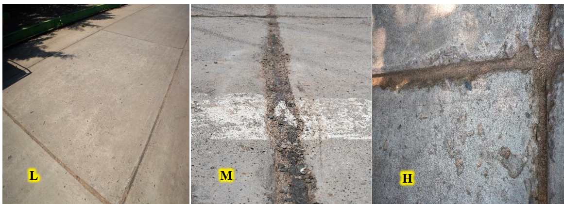
Figura 9. Daños de sello de junta en sus tres tipos de severidad. (Fuente: Elaboración Propia - 2019).
