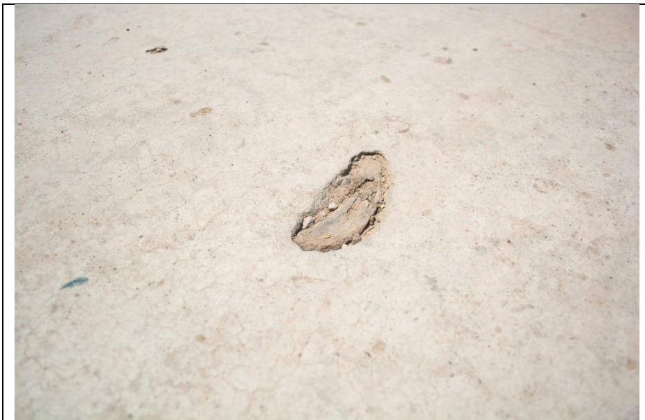
Foto 29: Daño de popouts muy notable.
