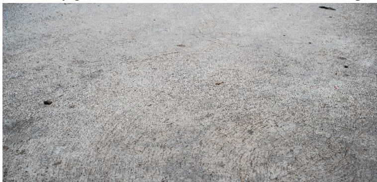
Figura 18. Daño de retracción. (Fuente: Elaboración Propia - 2019).
