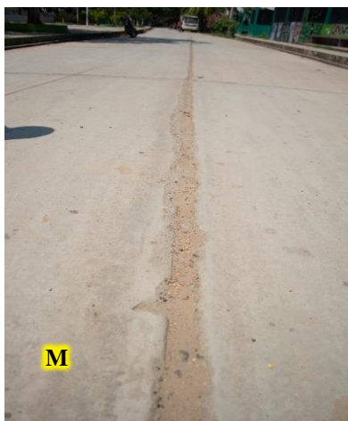
Figura 20. Daño de descascaramiento de junta de severidad M. (Fuente: Elaboración Propia - 2019).
