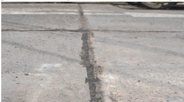
Figura 15. Daño de bombeo. (Fuente: Elaboración Propia - 2019).
