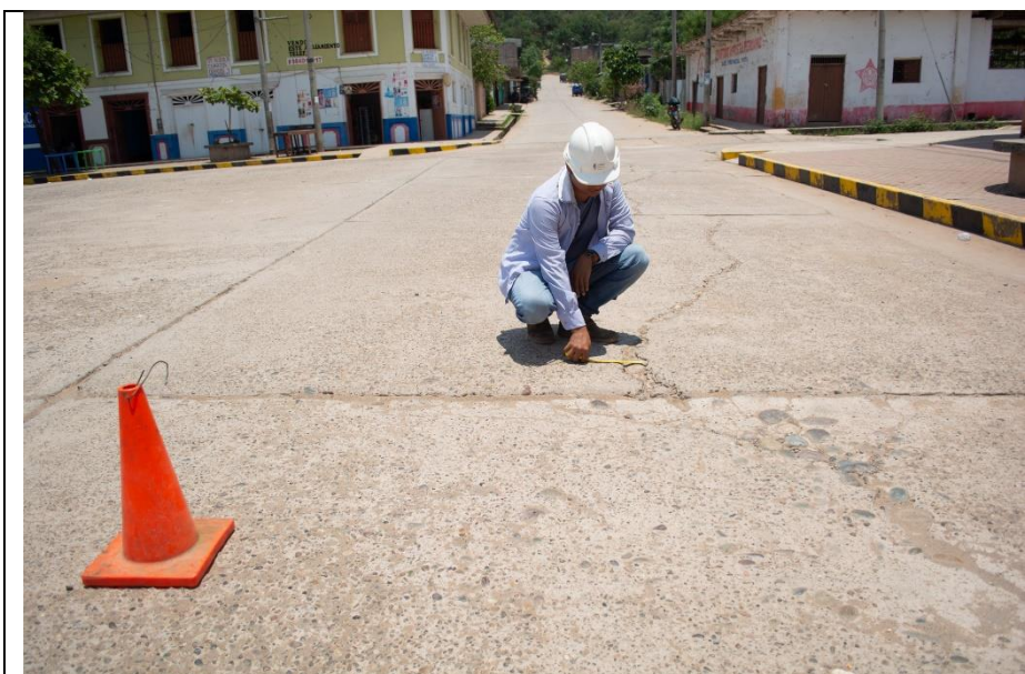
Foto 16: Realizando la medición del daño de grieta lineal para evaluar su severidad.
