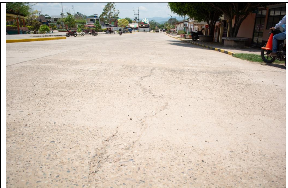
Foto 9: Reconociendo las patologías presentes en el Jr. San Martín C-5.
