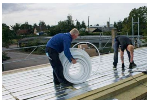
Figur 33 - Slangerne til varmepumpe i tagkonstruktion [1]
