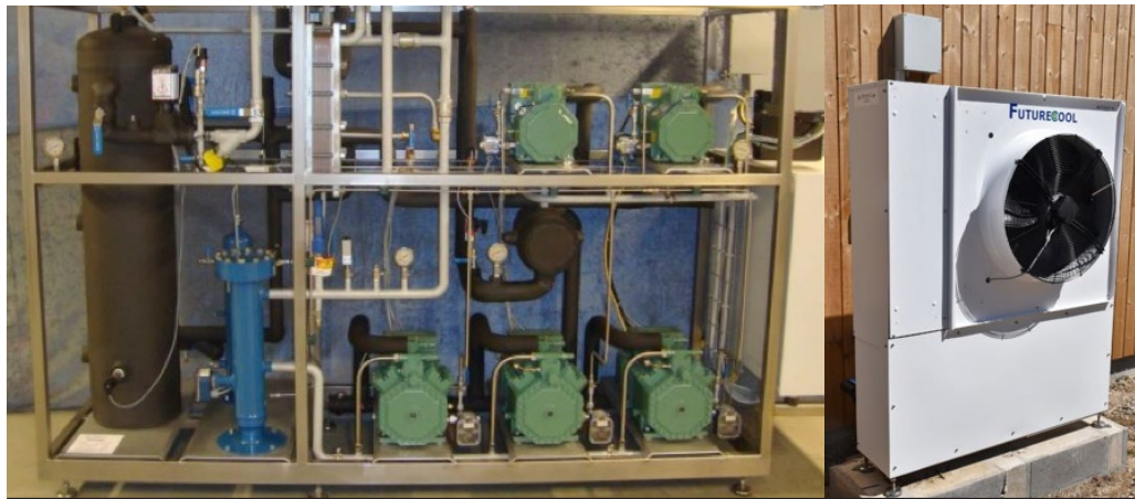
Figur 49 - Eksempel af et CO2 køleanlæg. Indendørs (til venstre) og udeenhed (luftkølet kondensator) (til højre) Kilde: JF køleteknik A/S
