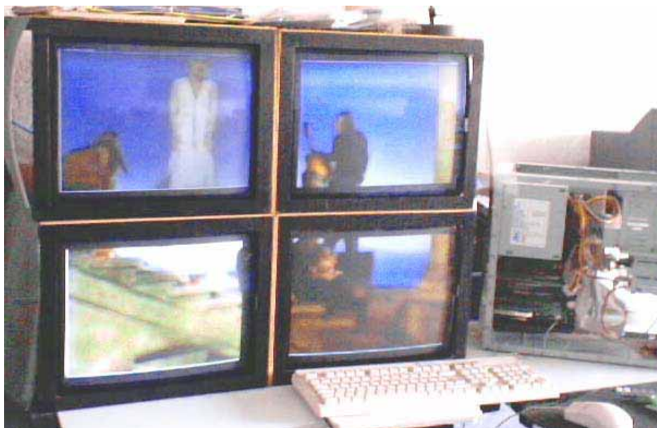
Figura5.27 Videowall de 4 monitores a pantalla completa
