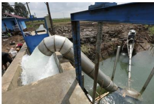
Gambar 2. Pompa air pada polder mini di Jejangkit, Kalimantan Selatan (Sumber: Kementan 2018)
